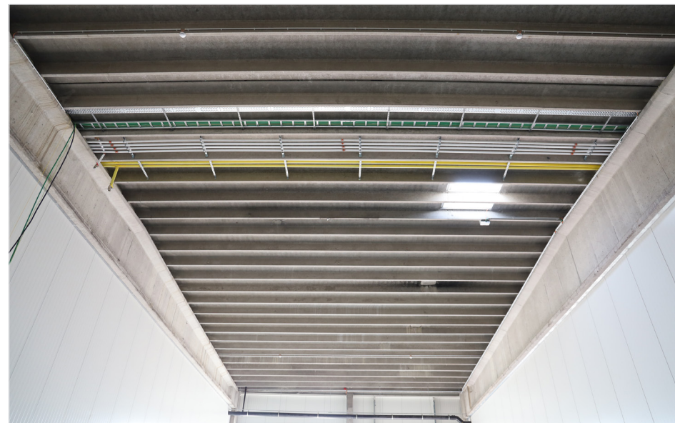
Binnenzijde unit: doorvoor bekabeling en leidingen, koepel voor rook- en warmteafvoer
