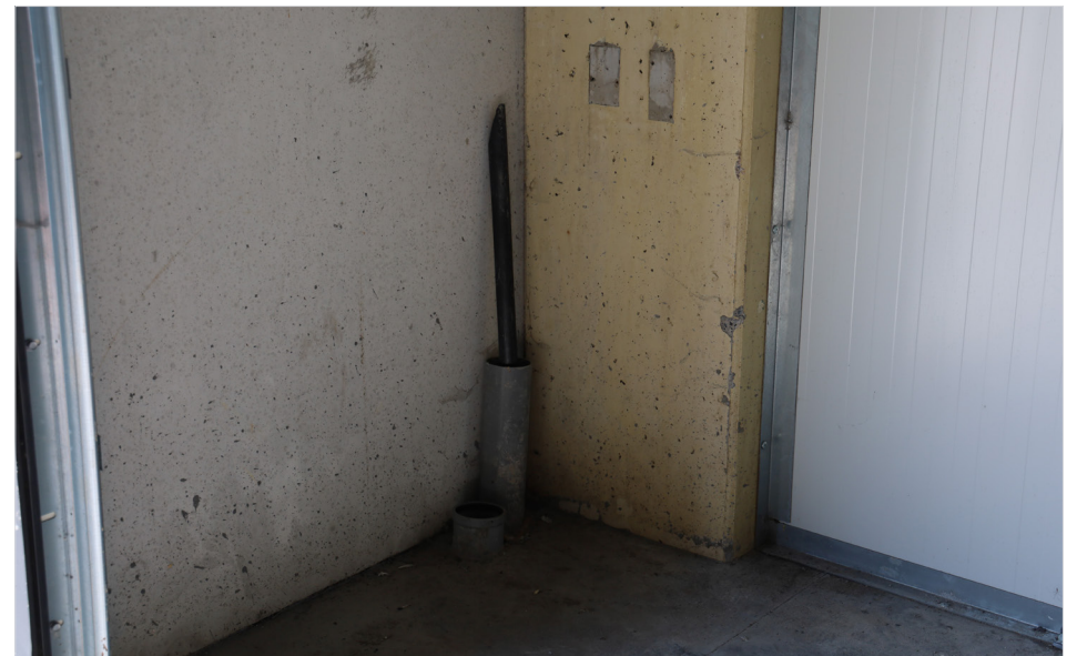
Binnenzijde unit: aansluitleiding regenwaterput en aansluiting waterafvoer
