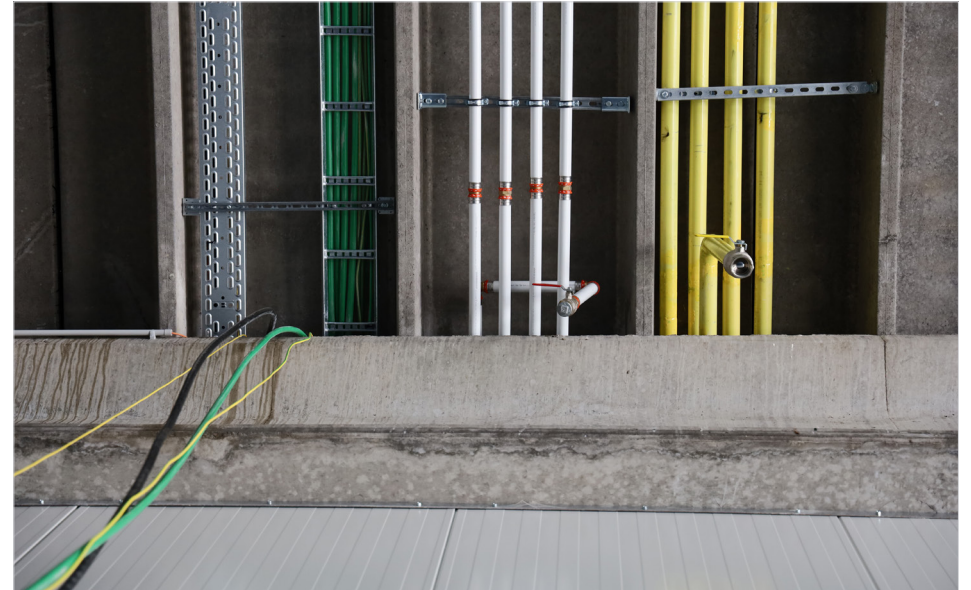
Binnenzijde unit: aansluitmogelijkheden elektriciteit, gas, data, drinkwater
